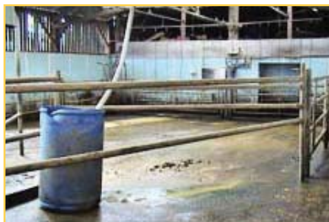
Barrière poussante dans le parc d'attente
